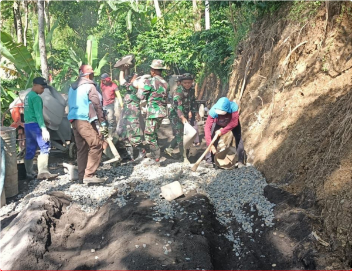
Anggota satgas TMMD Sengkuyung Tahap II Kodim 0719/Jepara bersama Polri dan warga gotong royong pengecoran jalan menuju Candi Angin
